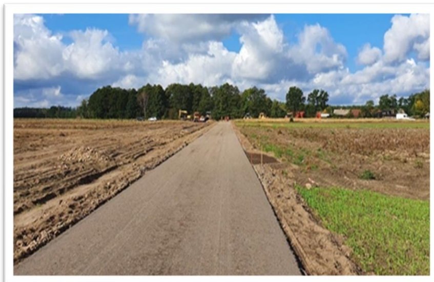
Fot. 9. Droga przed realizacją zadania
