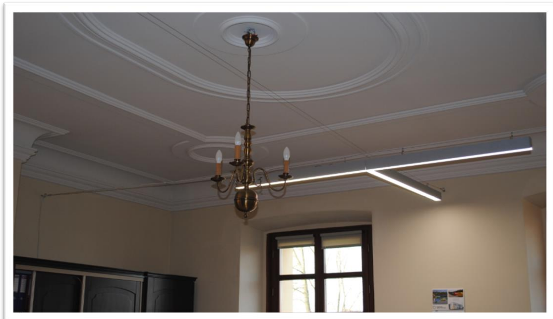
Fot. 18. Oświetlenie w biurze nr 205 po realizacji zadania
