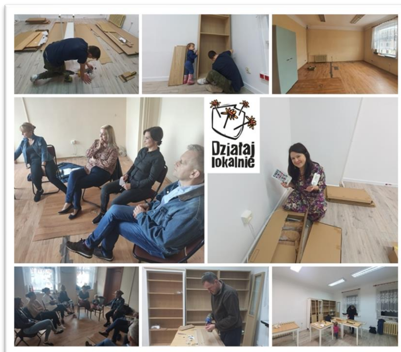
Fot. 38. Działania Stowarzyszenia Lepsze jutro, tworzymy dziś - remont pomieszczeń w byłym budynku UG
